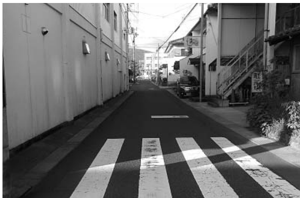
消えている車道外側線
