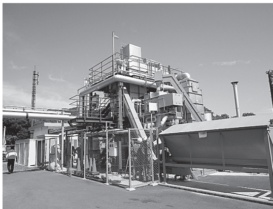
宮津バイオマスエネルギー製造事業所
