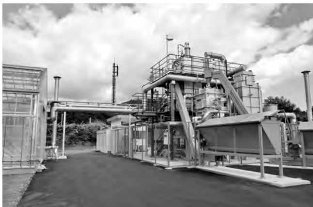
宮津バイオマス・エネルギー製造事業所
