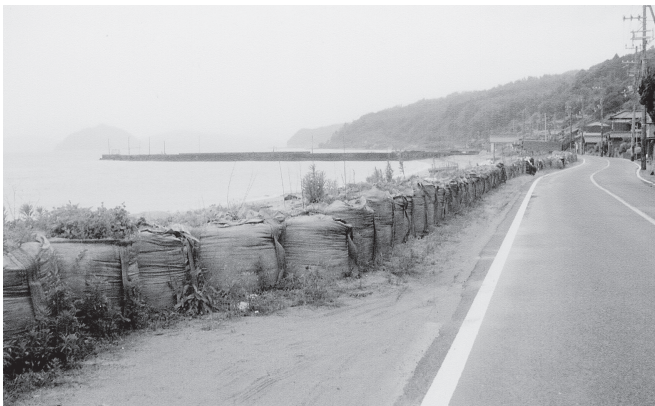
早期改修が必要とされる長江地区の道路
