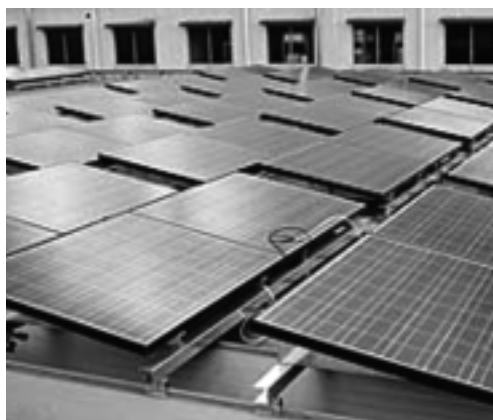
太陽光発電設備
