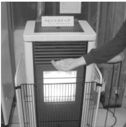
市役所市民ホールのペレットストーブ
