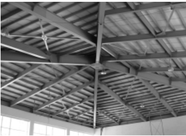
耐震化された由良小学校屋内運動場の天井
