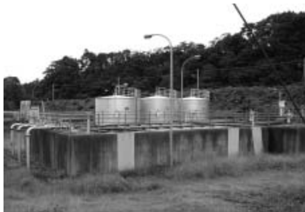
上宮津浄水場
