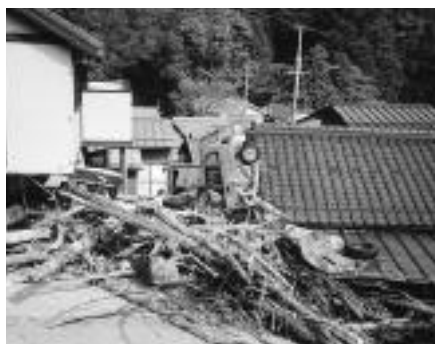
被災した滝馬地区の様子（一部）
