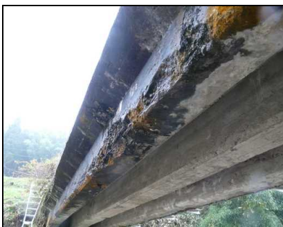
▲コンクリート橋の損傷
